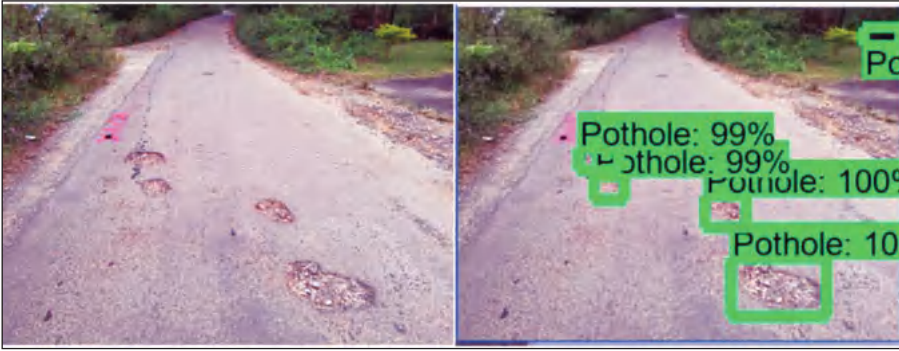
डीएल एम्बेडेड आईओटी उपकरण का उपयोग करके सड़कों में गड्डों की स्वतः पहचान
